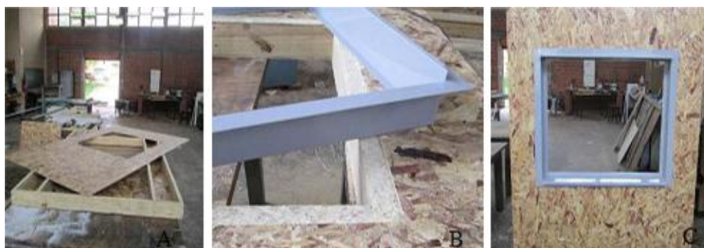
Figura 7. Aplicação da Chapa (A) – Marco + Pannel com Rebaixo (B) e Marco + Pannel (C). Fonte: O próprio autor
