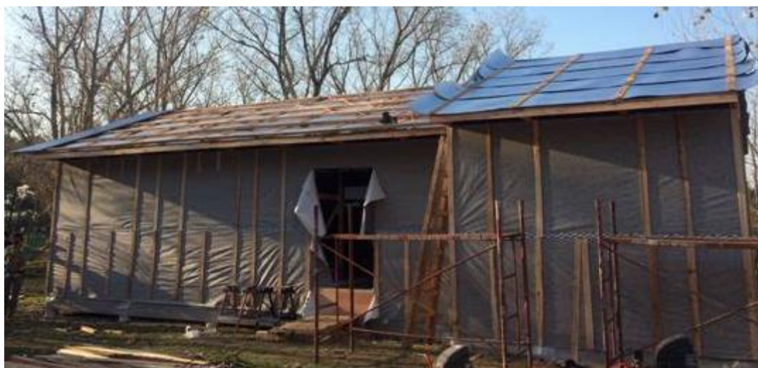
Figura 9. Envolvimento da construção com a colocação da membrana gás permeável e taliscas nas paredes.
