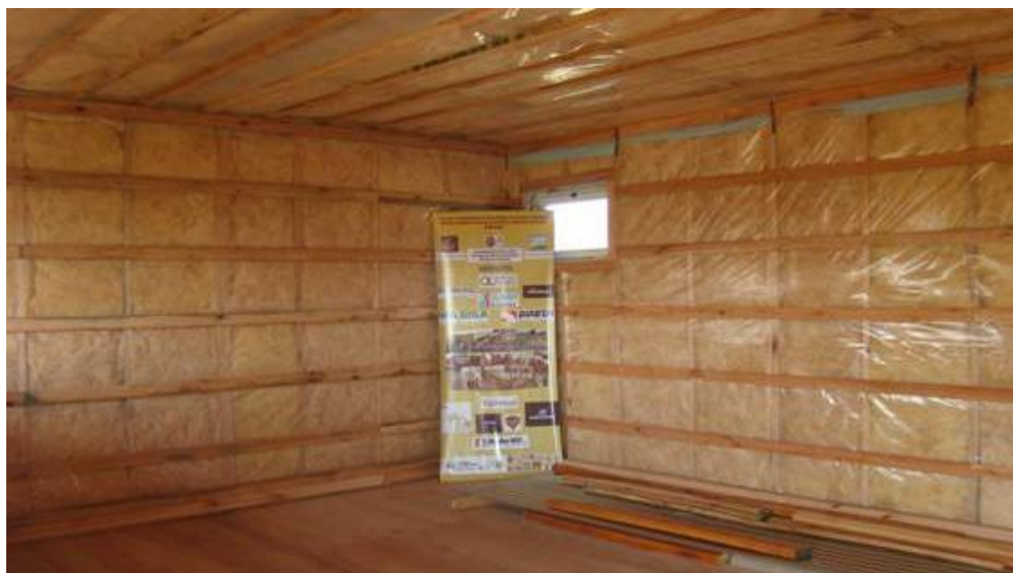
Figura 10. Revestimento interno das construções Wood Light Frame , com isolamento térmico com lã de vidro
