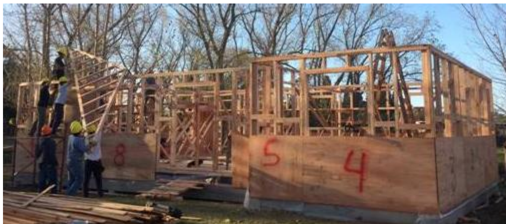
Figura 7. Quadros de paredes, parcialmente cobertos por painéis e quadro de tesoura sendo içado para fixação.
