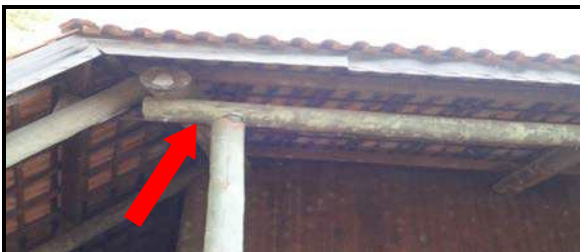
Fig. 4: Empenamento acentuado na estrutura. (Fonte: Emanuella, 2013).
