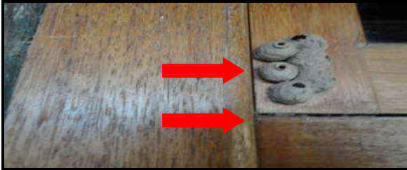
Fig. 2: Manifestação de microorganismos biológicos na estrutura de madeira. (Fonte: Rainy, 2013).
