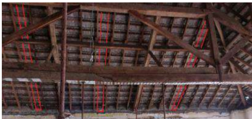
Figura 5. Necessidade de aumento da quantidade das vigas de apoio entre treliça e terça.
