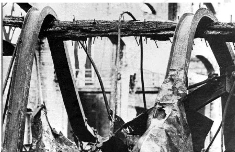
Figura 3 - Vigas de madeira e de aço submetida à situação de incêndio (MADEIRA ESTRUTURAL, 2009).
