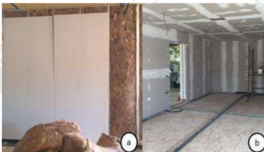
Figura 5. Colocação das placas de gesso acartonado (a), Ambiente preparado para fase de pintura (b).
