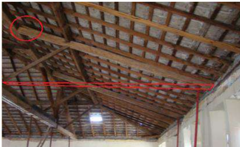
Figura 6. Ruptura da viga e sugestão de inclusão de vigas na horizontal. Fonte: BOURSCHEID, 2015 (arquivo pessoal).
