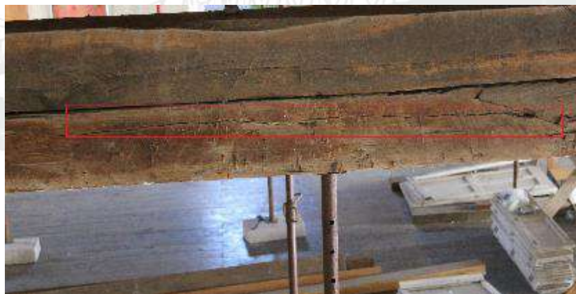
Figura 3. Escoramento de peças colapsadas. Fonte: BOURSCHEID, 2015 (arquivo pessoal).
